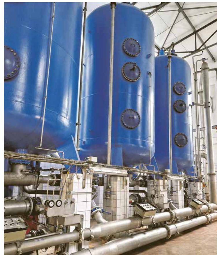
Blick in die Filterhalle im Spremberger Wasserwerk. Das Filtermaterial besteht aus halbgebranntem Dolomit, das den pH-Wert anhebt und die Kohlensäure entfernt.
